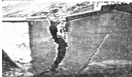
◀Рис.П.13.13. Разрушение оголовка водопропускной трубы морозным пучением грунта насыпи; рис. из /48/
