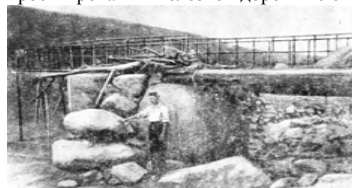
◀Рис.П.13.2. Последствия прохождения селя под автодорожным мостом (на фото видны огромные глыбы и обломки деревьев, принесенные к мосту селем и перекрывающие отверстие моста); рис. из /47/
