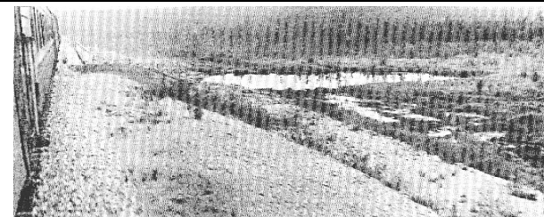
▲ Рис.1.8. Активизация термокарста в основании насыпи и ее подтопление (фото, БАМ, близ ст.Ларба); причина – плохой продольный водоотвод в районе водопропускного сооружения – малого моста (фото из /9/)
