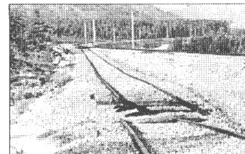
◀Рис.В.3. Размыв земляного полотна, балластной призмы и разрыв рельсовой колеи при отсутствии ИССО на ПК 4 обхода Кодарского тоннеля
