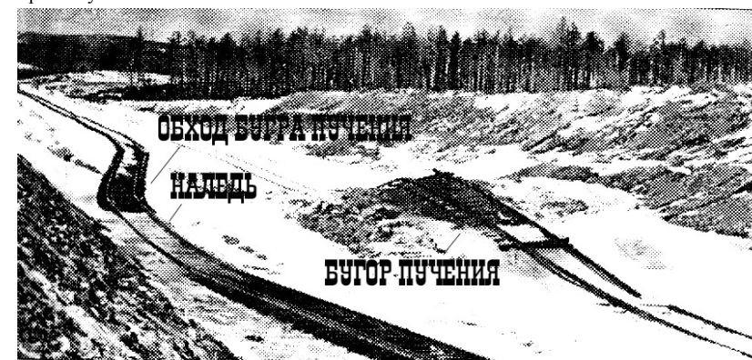
▲Рис.В.7. Обход бугра пучения в выемке на разьезде 246-го км БАМа участка Тында – Тунгала
