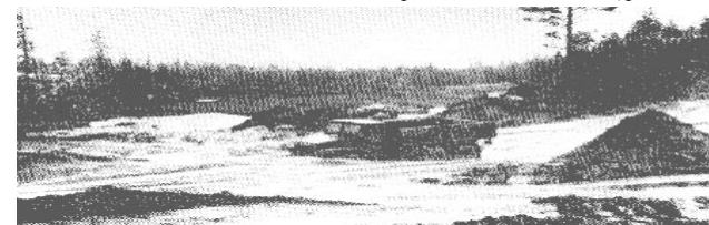
▲ Рис.1.10. Деформации притрассовой автомобильной дороги, отсыпанной из мелких и пылеватых песков, при сооружении железнодорожной линии Тюмень-Сургут; причины: высокие нагрузки, особенно от автомобилей-трубовозов (до 10 кН на ось); отсутствие или заполнение переувлажненным грунтом водоотводных канав (фото из /11/)
