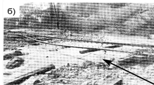
Размыв земляного полотна и разрушение верхнего строения пути
