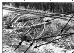
Наносы леса - результат карчехода Наледь, заполнившая отверстие трубы
