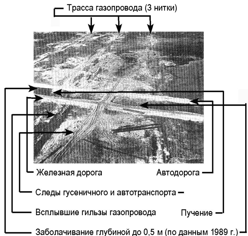
▲ Рис. П.13.14. Подтопление насыпи железной дороги Ягельная – Ямбург на участке ее пересечения с тремя нитками газопровода (аэрофотоснимок выполнен А.П.Бгатовым); рис. из /9/
