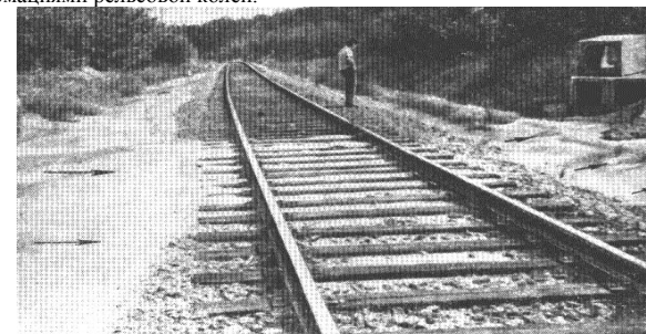
Рис.П.11.5. Перелив воды через земляное полотно во время паводка, произошедший в результате несоблюдения пятого гидравлического требования; рис. из /42/
