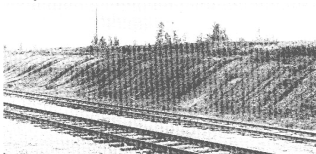
▲ Рис.1.6. Размыв откосов выемки с образованием застойного скопления поверхностных вод в основании земляного полотна (фото, БАМ, участок близ ст.Ларба /9, рис.19/); причина - плохой продольный водоотвод, не защищающий выемку от поверхностного стока
