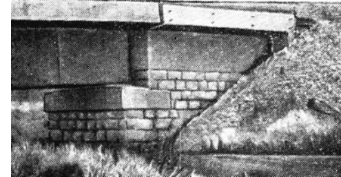
◀ Рис. П.13.17. Крен устоя малога железнодорожного моста в сторону насыпи вследствие протаивания грунтов основания; рис. из /48/
