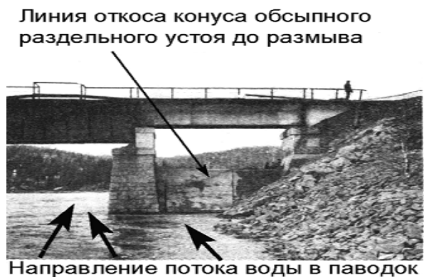
◀Рис.П.10.2. Подмыв конуса обсыпного раздельного устоя моста через р.Томь на железной дороге Новокузнецк – Абакан (107-й км)
