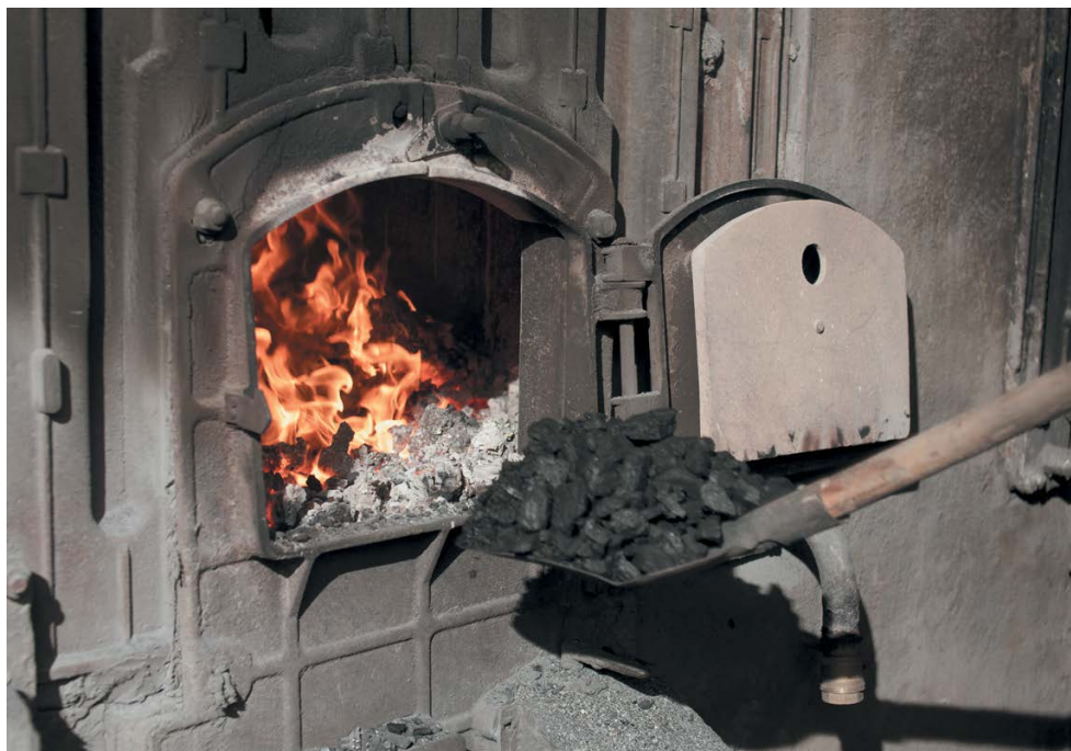
Рис. 34. Котел на угле
