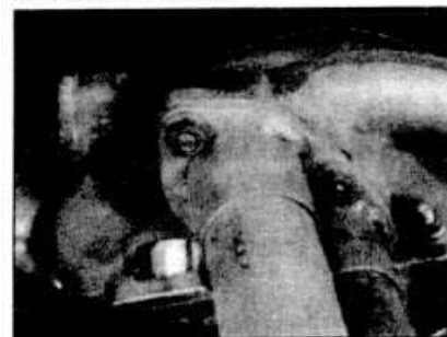
16.3 Фланцы отводящей выхлопной трубы на коллекторе
