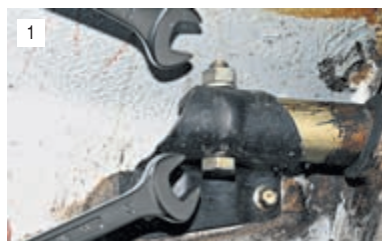
1 Ключом «на 22» оворачиваем гайку крепления кронштейна бампера к кронштейну брызговика, удерживая болт от проворачивания ключом того же размера. Вынимаем болт.
