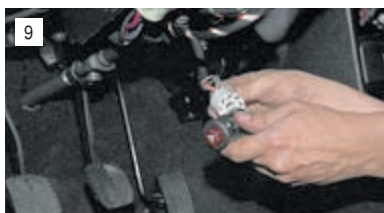
9 Для замены выключателя аварийной сигнализации снимаем его с соединительной колодки и устанавливаем новый.
