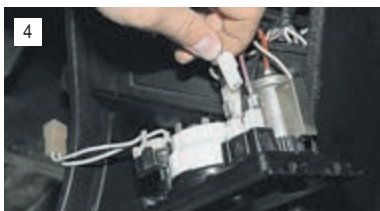
4 Отсоединяем наконечники проводов от выводов лампы блока сигнализаторов, предварительно пометив порядок их подсоединения.
