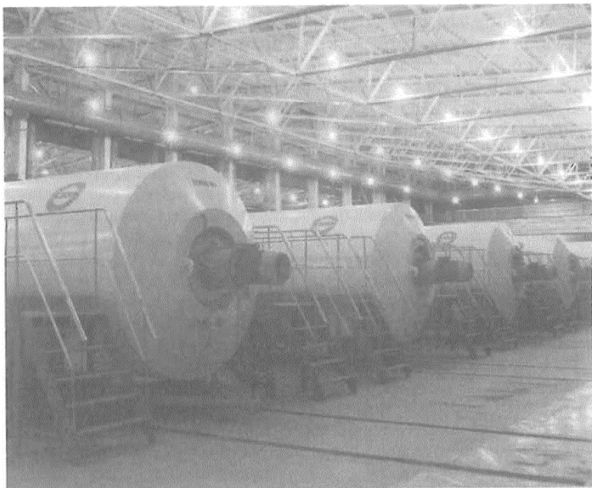
Установка термостатирования газодиффузионного завода
