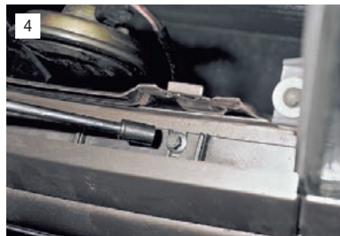
Сняв решетку радиатора, головкой "на 10" отворачиваем два болта крепления бампера к панели передка.
